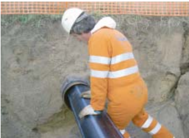
Riabilitazione di condotta esistente con impiego di tecnologie trenchless utilizzando tubi in PEAD (polietilene ad alta densità)
